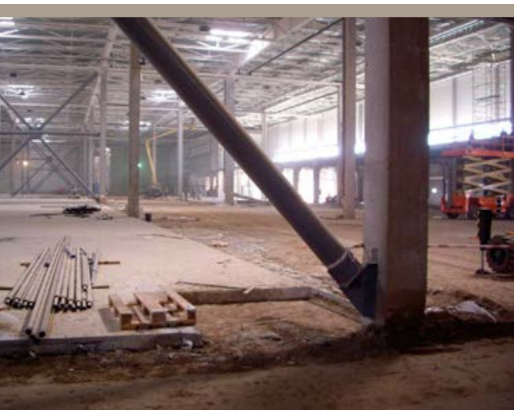
↑ Odciągi rurowe dla usztywnienia słupów hali (źródło: materiały własne LLS)
